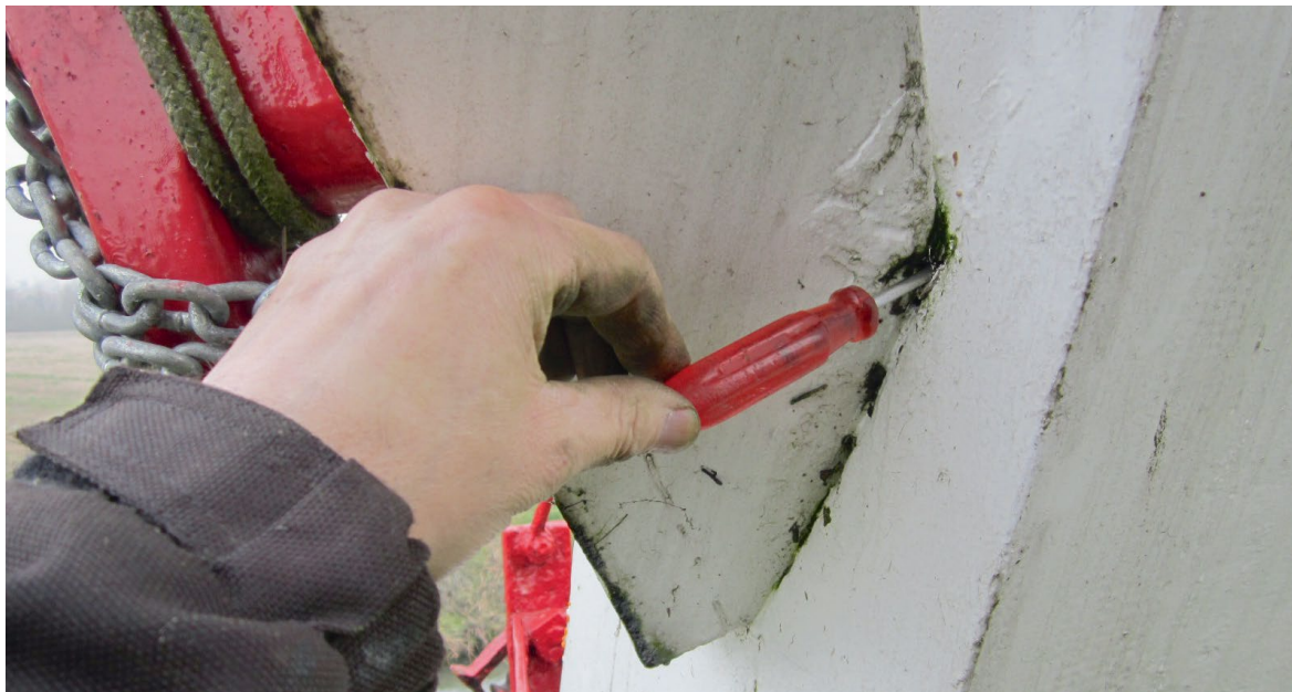
Figuur 34: Aantasting bij de aansluiting van twee balken. Foto: Van Reeuwijk bouwmeester
