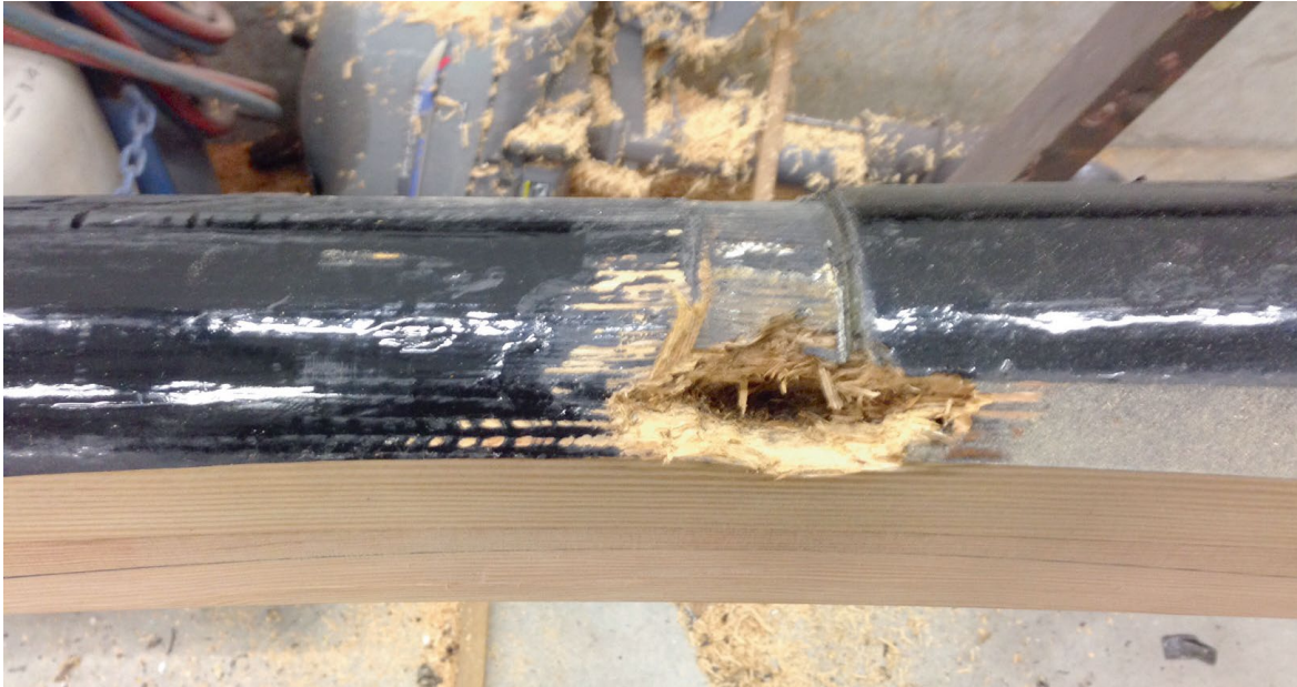
Figuur 18: Voorbeeld van houtrot onder bevestigingspunt op een houten mast. Bron: Jachtwerf fa. M. van Duivendijk
