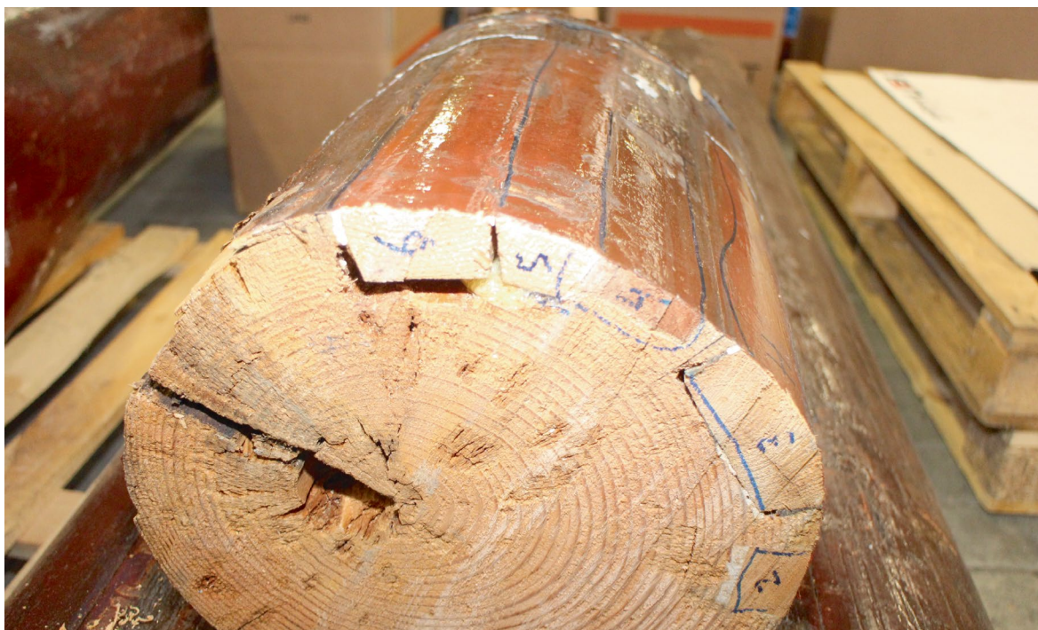
Figuur 13: Dwarsdoorsnede mastdeel achter gaffelplaat met reparatielatten en windscheuren. Bron: Onderzoeksraad voor Veiligheid
